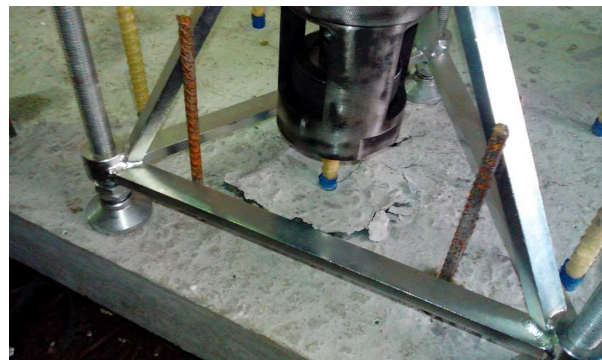
Рисунок 7 – вырыв СППС из бетона
