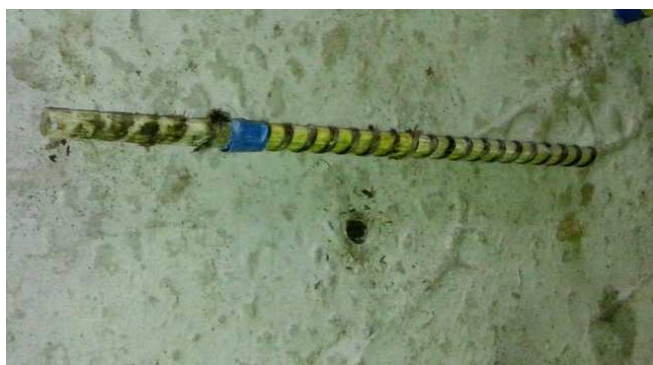
Рисунок 5 – характер разрушения узла сцепления связей КС1 и бетона
