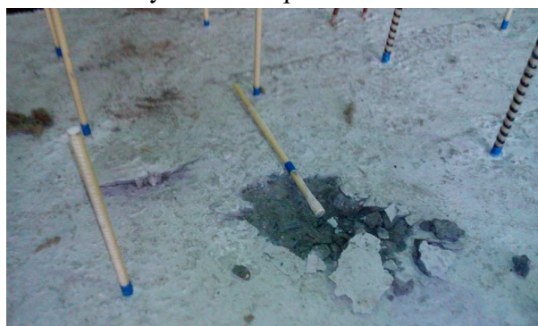
Рисунок 9 – характер разрушения узла сцепления связей СПА7,5 и бетона
